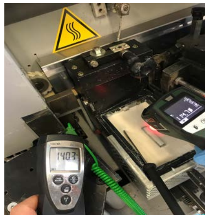
Figura 58. Temperatura rilevata: differenza tra termometro a immersione e termometro a infrarossi
